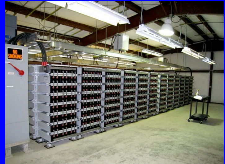
1MW / 1.4MWh Feb. 1997
